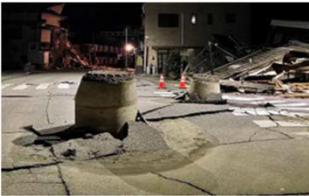
マンホール浮上（輪島市）
