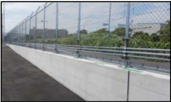
海岸保全施設（止水壁）
