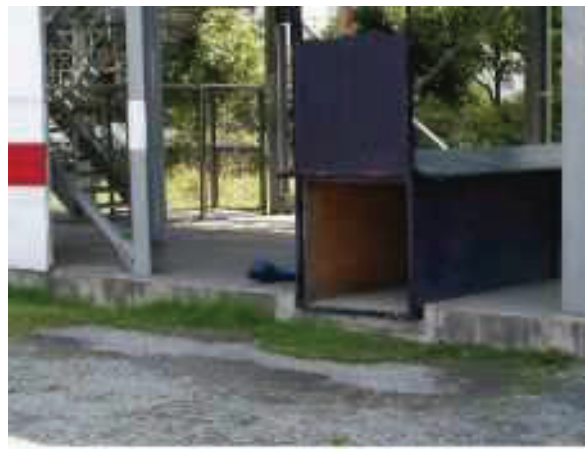
B塔 煙道出口
