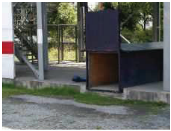
B塔 煙道出口
