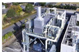
コジェネレーションシステム
