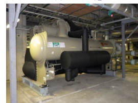
空調熱源設備
