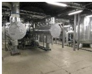
全館空調冷熱供給システム
