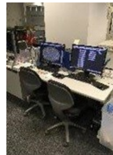
全館空調管理システム
