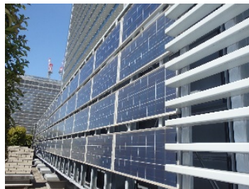
太陽光パネル
