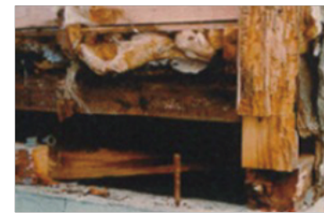
写真 4.1.3 結露による腐朽
