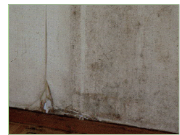
写真 4.1.2 カビによる汚損
