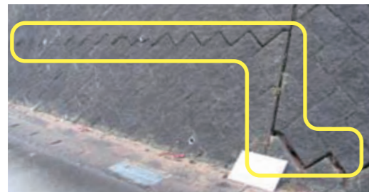
連続した亀裂
