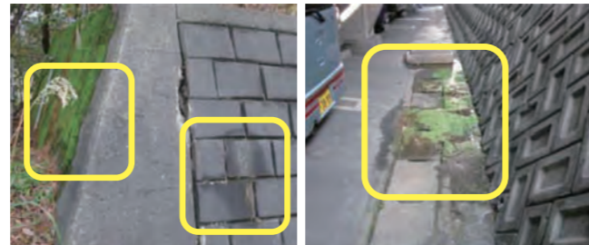
水がしみ出ている擁壁
