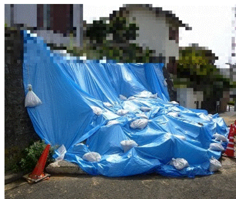
擁壁が崩壊した事例
