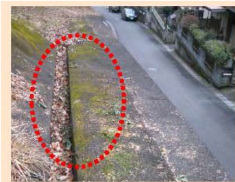
①排水溝のつまり
