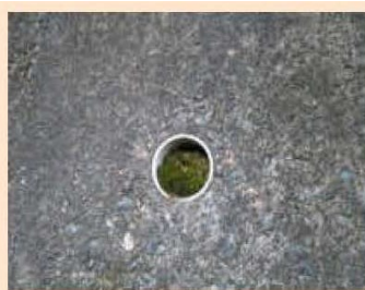
②水抜き穴のつまり
