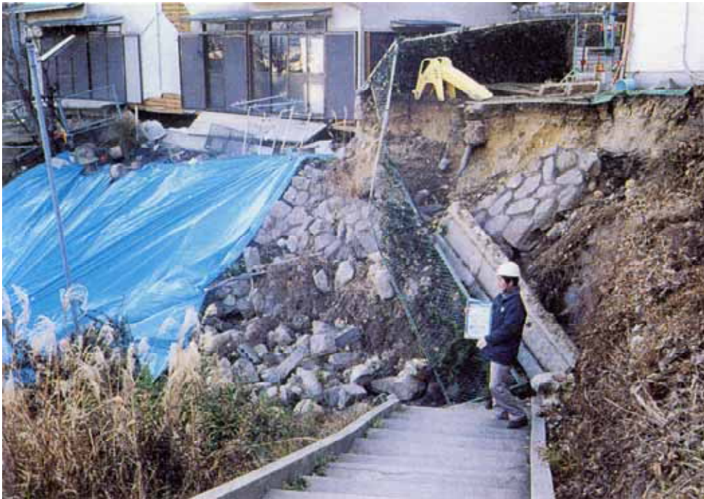
写真 - 3 「平成7年兵庫県南部地震被害調査中間報告書」より
