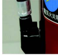
× 消火薬剤の漏れ
