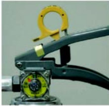
× 安全栓の抜けかけ
