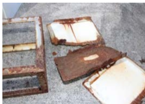
【看板の中が錆びてもろくなっている状況】
