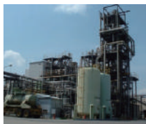
横浜工場の製造設備
