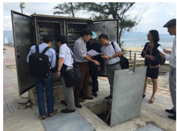
下水道ポンプの効率性等の調査
