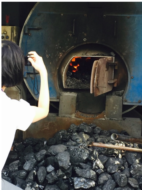
水産加工会社の石炭ボイラー
