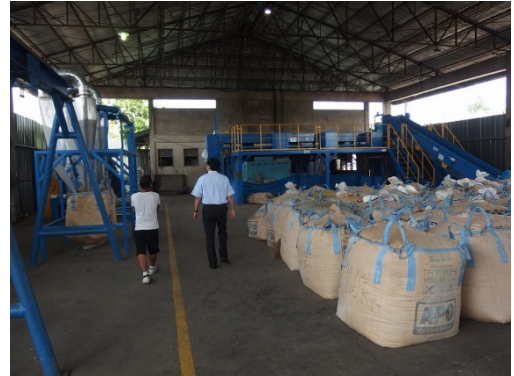
写真1 JICA普及・実証事業によるパイロットプラント
