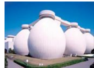
卵形消化タンク (北部下水道センター)
