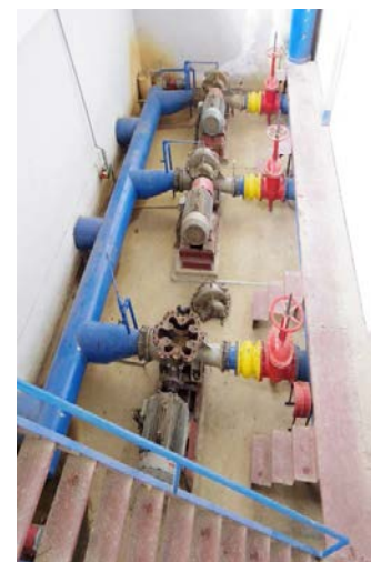
ダナン市浄水場の原水ポンプ
