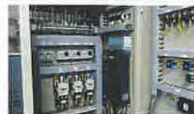
熱源ポンプ流量制御装置(内部)
