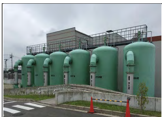
(写真1) 膜ろ過棟の混和槽
