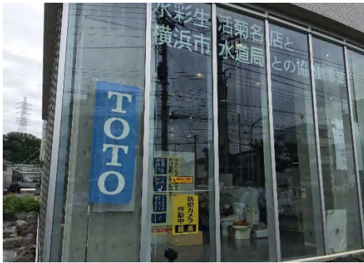
(写真8) 光触媒ガラス散水システム
