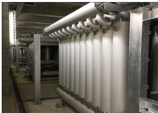
(写真2) 膜ろ過装置
