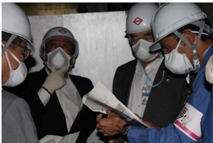
資源循環局都筑工場の耐震補強工事の現場を確認する監査委員
