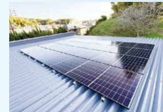
▲町内会館に設置した太陽光パネル
