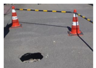
取付管破損による道路陥没
