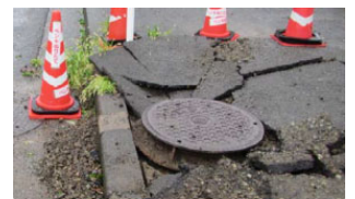
マンホール浮上被害状況
