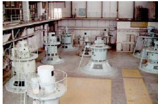
磯子ポンプ場内観
