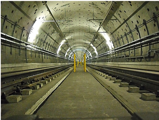
<トンネル照明>
