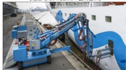
【クルーズ船への陸上電力供給(ハンブルク港)】
