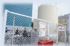
貯蔵してある LP ガスは、災害時にも活用可能
