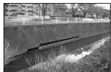
平戸永谷川の河川護岸崩落
