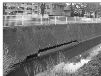
平戸永谷川の河川護岸崩落
