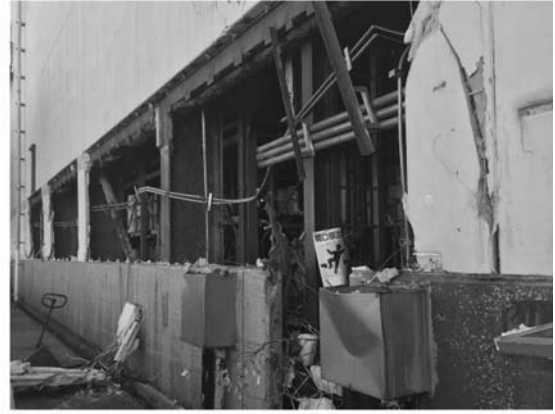
波によって壁面が大破した社屋（金沢区）
