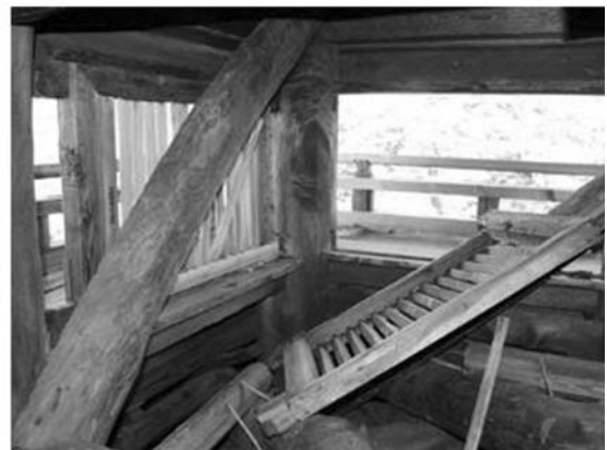
三溪園・旧燈明寺三重塔（重要文化財）の破損（中区）
