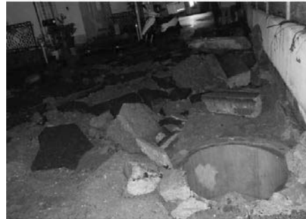
図2：マンホール蓋損傷例（横浜市磯子区）
