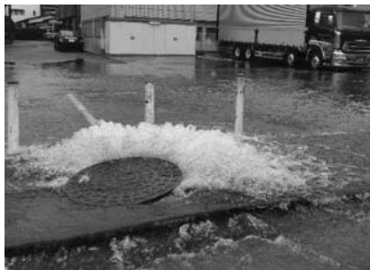
図1：マンホールからの雨水噴出例
