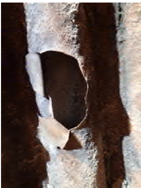
ボイラ水管穴あき詳細
