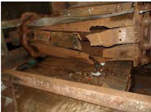
資源選別施設 老朽化したコンベヤ
