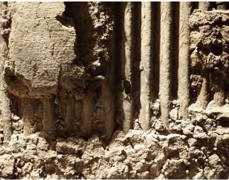
焼却工場 穴の開いたボイラ水管
