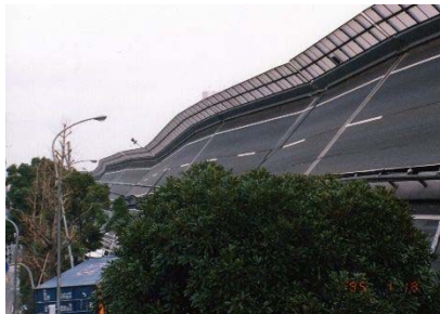
阪神高速道路の高架橋の倒壊
