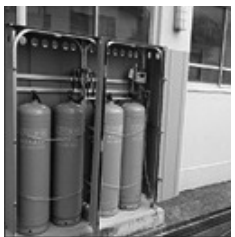
写真3 LPガスボンベ庫
