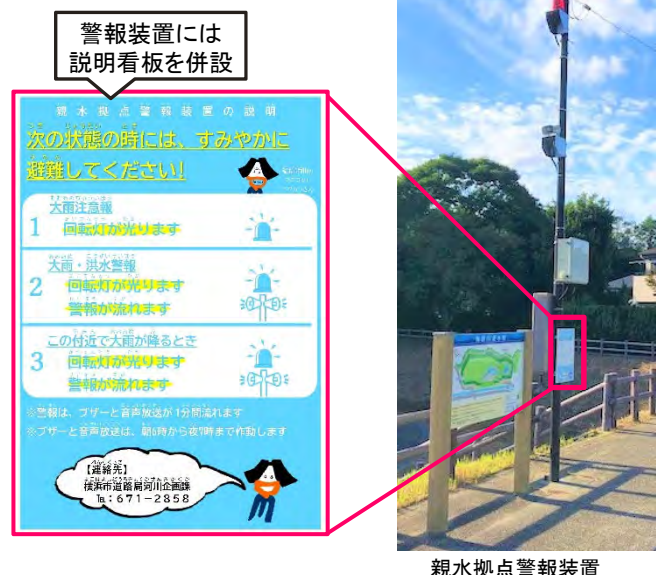
親水拠点警報装置
