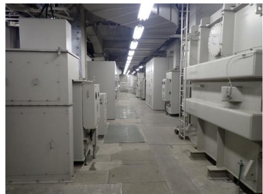
&lt;変電所機器&gt;
