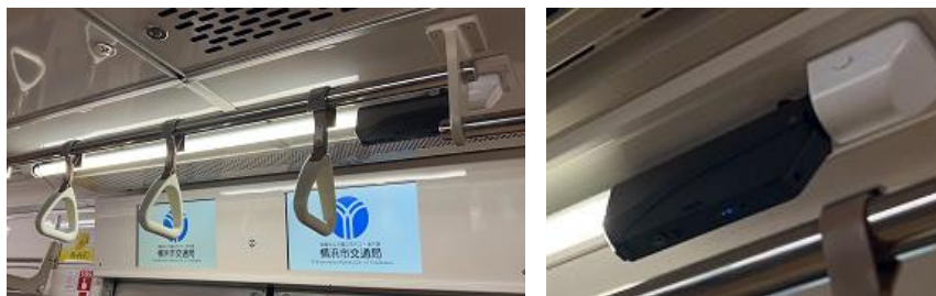
<3000S形車両に設置した防犯カメラ>
