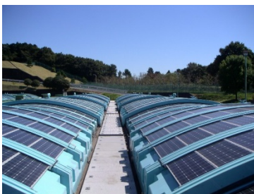
太陽光発電（小雀浄水場）
