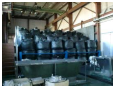
小雀浄水場の既設活性炭設備
