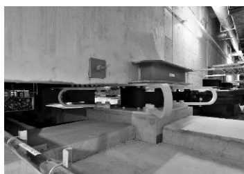
免震・制震装置
