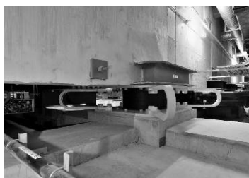
免震・制震装置
