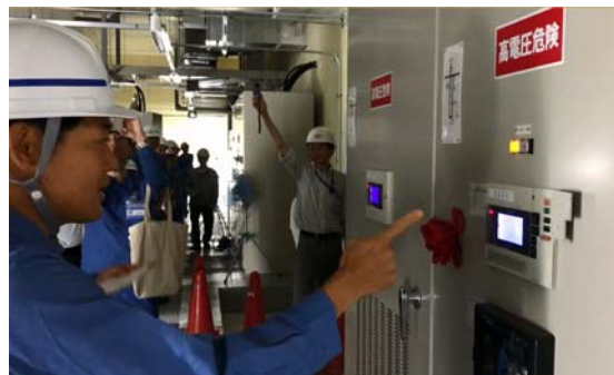
高圧盤①に電気が流れる
