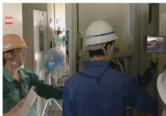
低圧盤に電気が流れ電気室の照明が点灯
