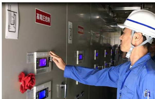
高圧盤②に電気が流れる
