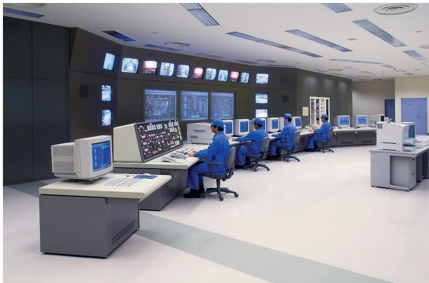
資源循環局金沢工場の監視制御装置
