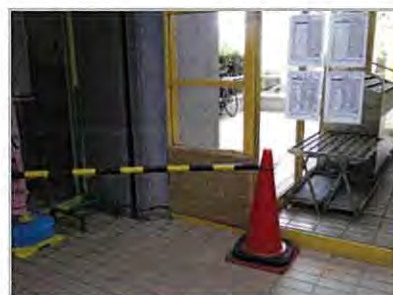
玄関脇のガラス破損
