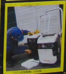
「ガス式発電機」の点検
