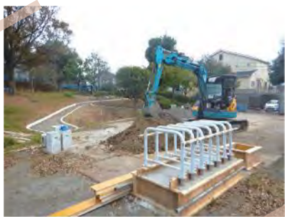
園路を再整備し、車止めを制作中の岡津公園。引き続きベンチや砂場の更新等の工事を実施します。
