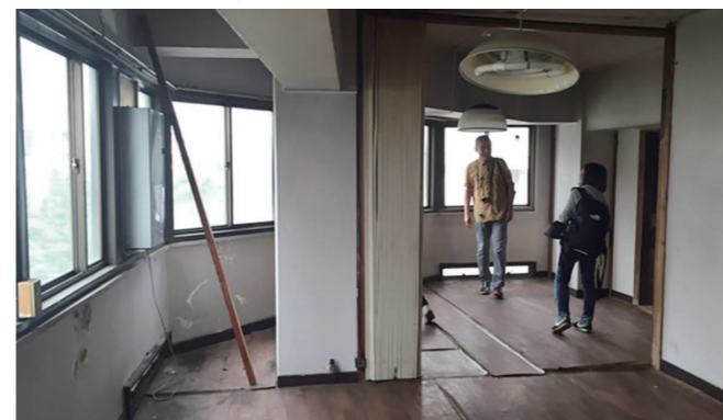
施工前 壁面、天井、床材など、全体的に老朽化している
