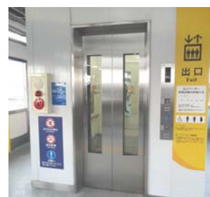
（写真）駅舎エレベーター
