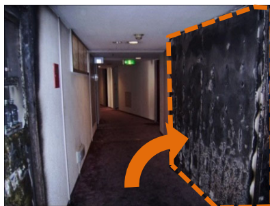
防火戸を開けた状態 ※点線部＝防火戸
