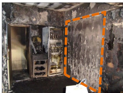
火災発生現場
