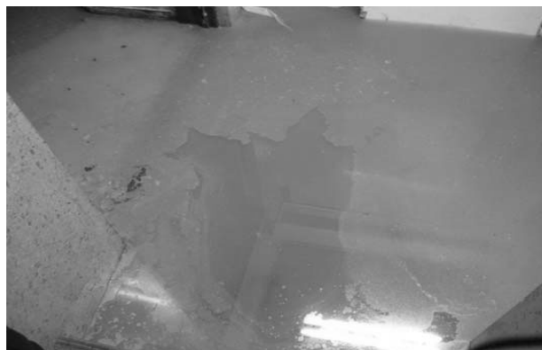
写真1 地下1階の汚水による水没
