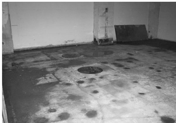
写真3 汚水の排出後の地下1階
