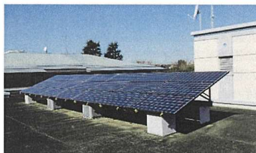
屋上に設置している太陽光発電
