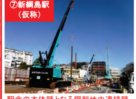
⑦新網島駅(仮称) 駅舎の本体壁となる鋼製地中連続壁の建て込み工事を実施しています。
