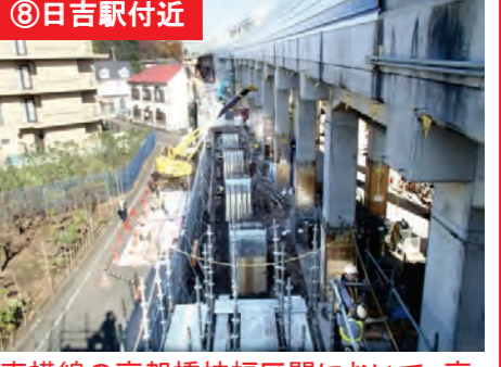
⑧日吉駅付近 東横線の高架橋拡幅区間において、高架橋の柱工事を実施しています。
