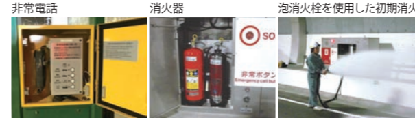
④ トンネル内の防災安全設備
