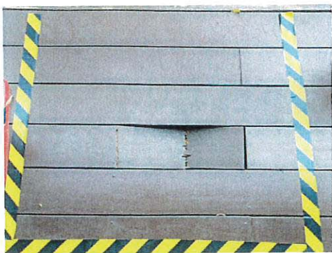
【2021年5月外廊下(テラス)踏み抜け事案：市区役所とご相談し継続対応中】
